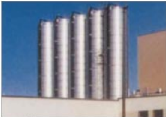
Tanques de almacenamiento tipo silo de 60.000 galones—cubierta exterior de acero inoxidable.
